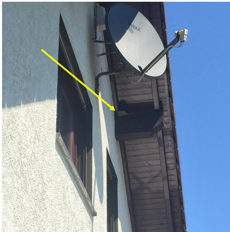
Abbildung 6-6. Vogelnest auf einer Dachpfette an der Südostfassade des Hauses.
